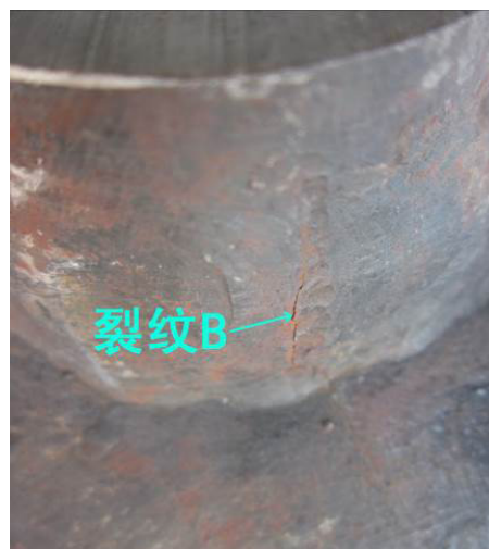
图1-2 蒸汽管线加强管座处的宏观形貌（切割后，外壁）
